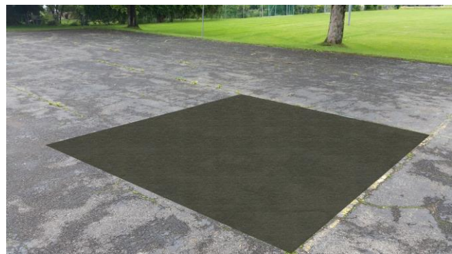
Ein einheitliches Gesamtbild und Schutz gegen die weitere Auflösung der Oberfläche.
