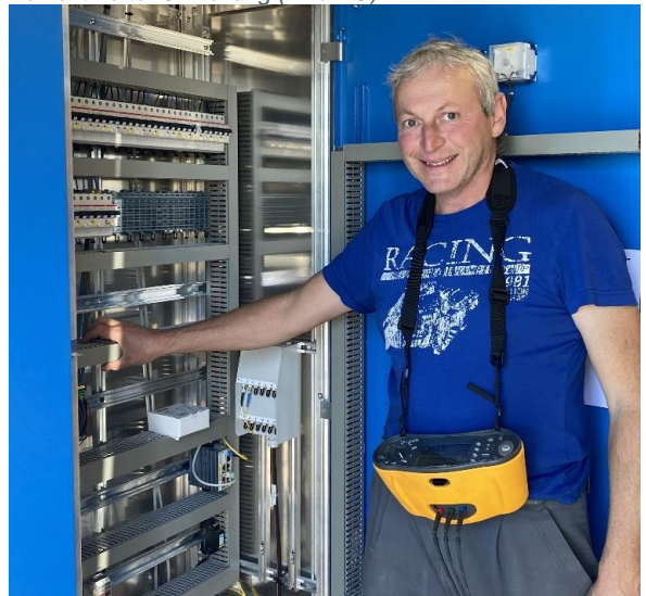
Hans Schmid, Leiter elektrische Anlagen, bei der Inbetriebnahme der Steuerung
