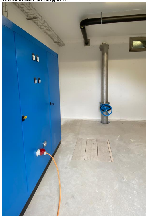
Steuerung und Zulauf Kammer 1
