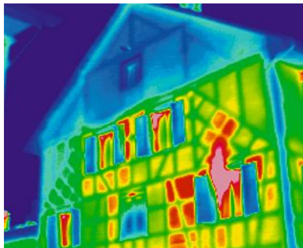
Wärmebildaufnahme eines Gebäudes: «Gesamtsanierungen bringen die höchsten Energieeinsparungen.» (Foto: EnergieSchweiz)
